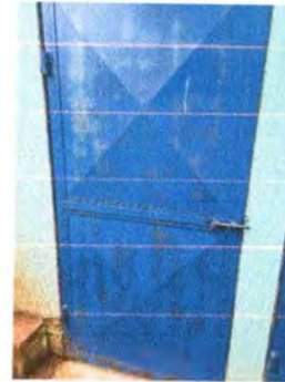
Foto 8: Las puertas se encuentran en mal estado.
