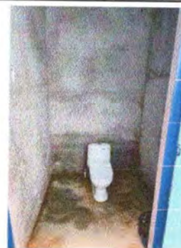
Foto 6: Los baños no cuentan con azulejo.
