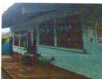
Foto 5: Se observa la pintura en mal estado.
