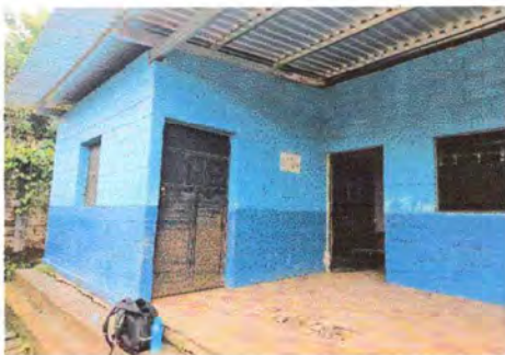
Foto 3: Proceso de las gradas que estaban en muy mal estado.
