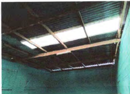
Foto 1: Se observa que la lámina está deteriorada por lo que se sustituirá.
