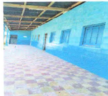
Foto 2: Se observa que la estructura se encuentra en mal estado.
