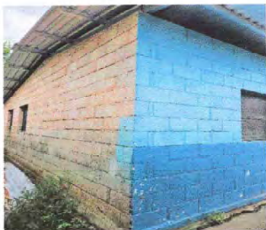
Foto 3: Se observa que la pintura está en mal estado.
