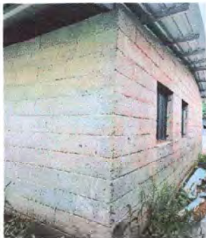
Foto 1: Se observa que la pared carece de columna, lo cual representa peligro.
