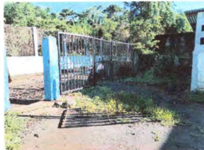
Foto 2: Se observa que el portón está deteriorado.
