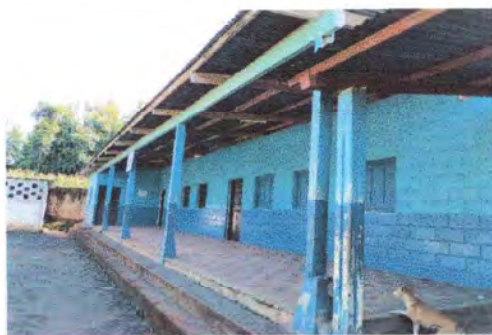
Foto 3: Las gradas están en muy mal estado.
