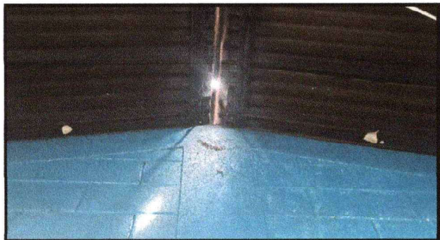
Foto 1. se observa el mal estado de la lamina existente
