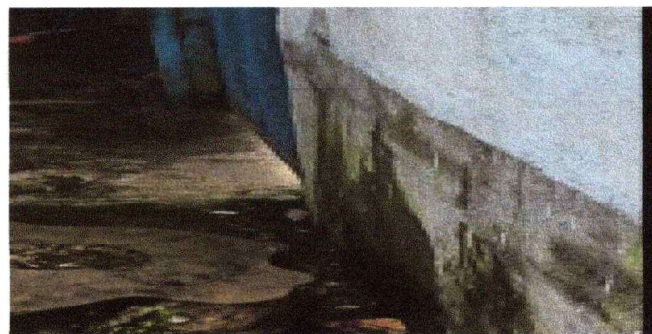
Foto 2. Se observa la necesidad de la pintura en las paredes
