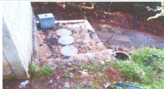
Foto 6: Se observa como quedo el biodigestor
