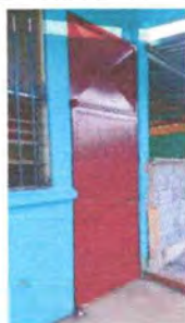
Foto 3: Se observa la puerta nueva del salon
