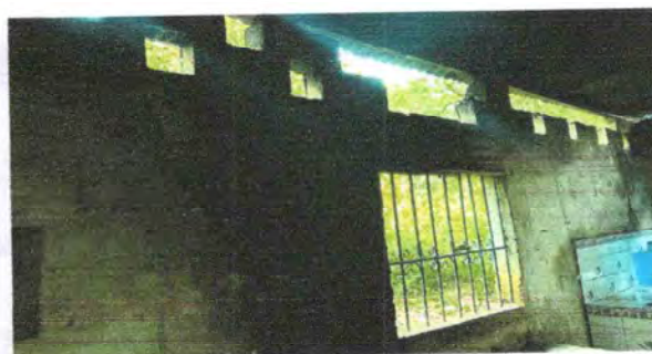
Foto 2: Se observa muro deteriorado.
