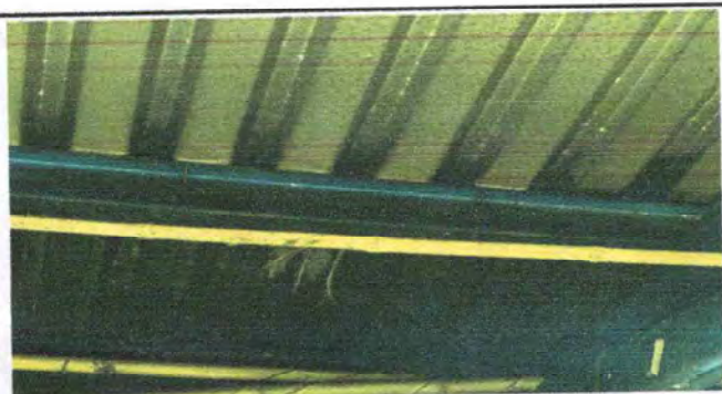
Foto 5: Se observa lámina deteriorada.
