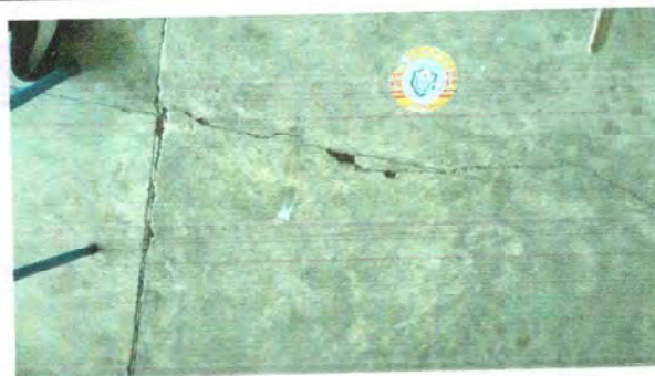
Foto 10: Se observa el piso en mal estado
