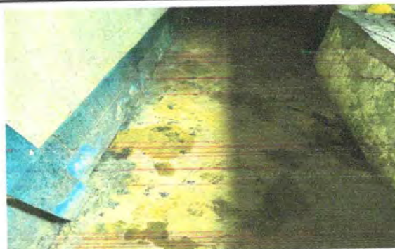
Foto 4: Se observa el mal estado del piso
