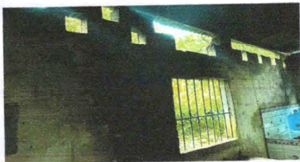
Foto 3: Se observa el muro sin repello
