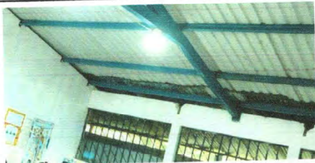
Foto 11: Se observan láminas en mal estado.
