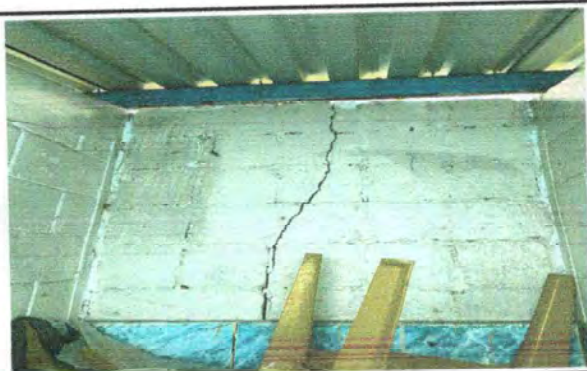
Foto 9: Se observa muro actualmente en mal estado.
