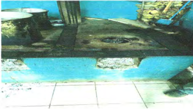
Foto 1: Estufa actual en mal estado.
