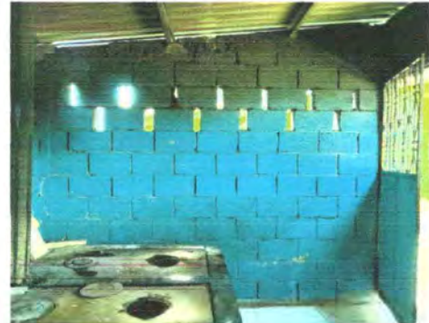
Foto 2: Se observa la necesidad de una ventana en muro por el calor que genera.
