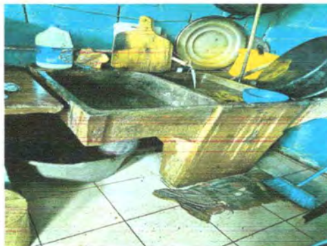
Foto 3: Pila actual deteriorada.
