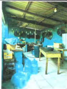
Foto 7: Se observa la necesidad de conformar muro para mayor ventilación incluye el desmontaje.
