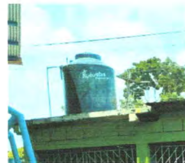
Foto 6: Rotoplas en mal estado.
