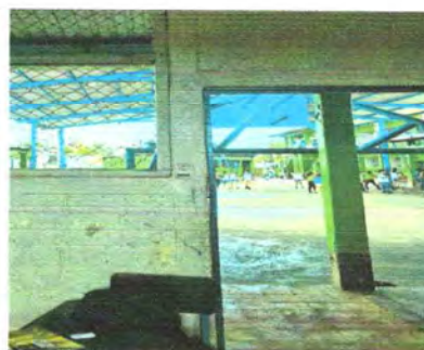
Foto 10: No se cuenta con puerta.
