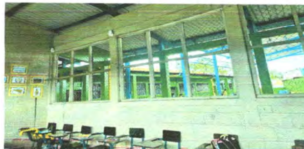
Foto 8: No se cuenta con ventanería.
