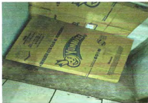
Foto 5: Se observa no cuenta con piso cerámico.
