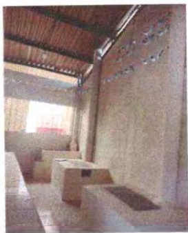
Foto 1: Se observa como quedo la estufa
