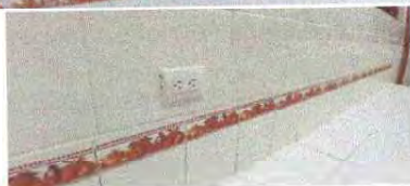
Foto 7: Se observa como quedo el sistema electrico
