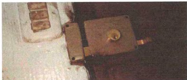
Foto 19: Se observa como quedaron las chapas de las puertas
