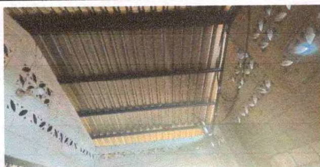
Foto 11: No cuentan con pintura las paredes.
