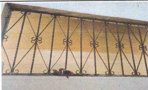
Foto 9: Las ventanas requieren mantenimiento.
