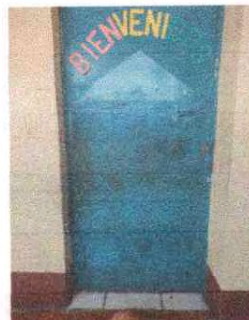
Foto 20: Se observa que las puertas necesitan mantenimiento
