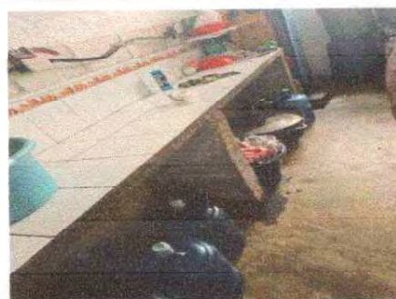
Foto 6: No se cuenta con azulejo.
