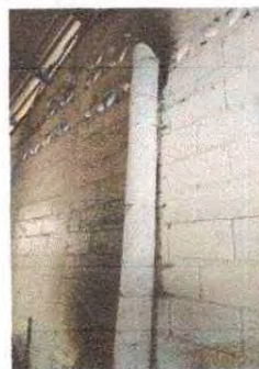
Foto 4: Chimenea en mal estado.
