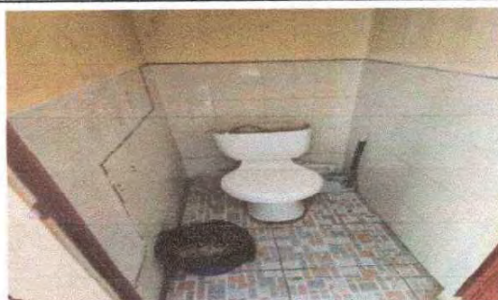
Foto 12: Se observan los sanitarios en mal estado.
