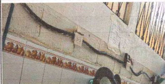
Foto 7: Sistema eléctrico en mal estado.
