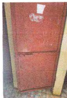
Foto 10: Se observa puerta en mal estado.
