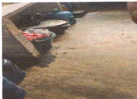
Foto 8: No cuenta con piso cerámico.
