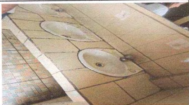
Foto 13: Se observa los lavamanos incompletos.
