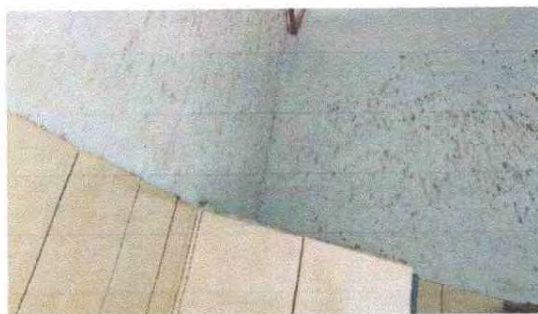
Foto 17: SE observa que no cuenta con pintura.
