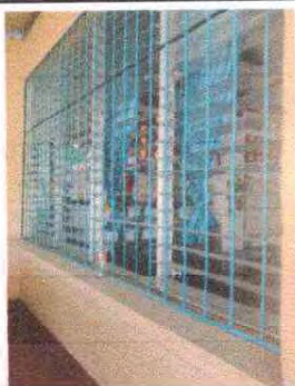
Foto 21: Se observa que los balcones necesitan mantenimiento
