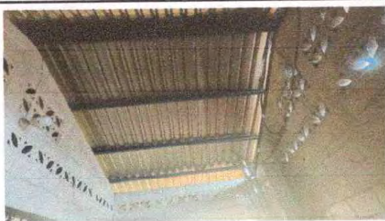
Foto 5: No están repelladas las paredes.
