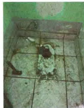
Foto 4: Se puede observar el cambio de los inodoros.
