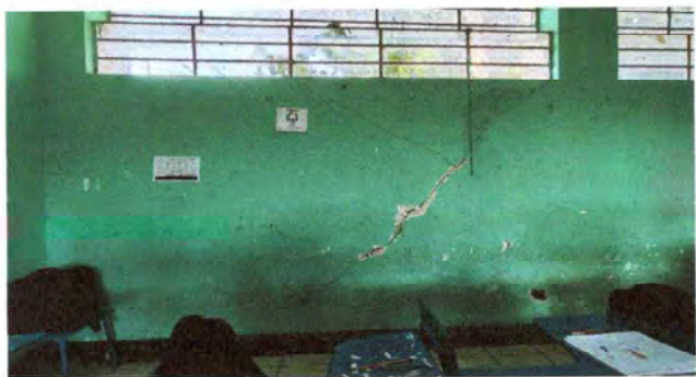
Foto 1: Se observa que el muro de las aulas, que se encuentran con grietas.
