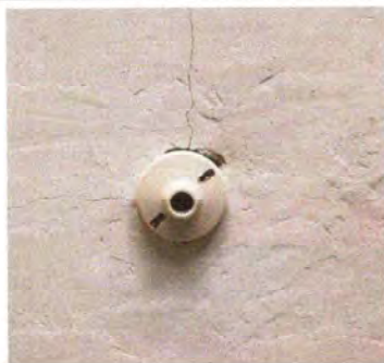
Foto 7. Se observa la necesidad del sistema electrico
