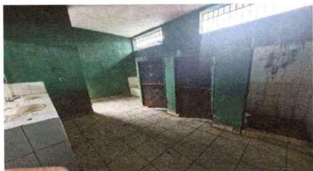
Foto 3: Se observa la necesidad del mantenimiento de la puerta de los baños
