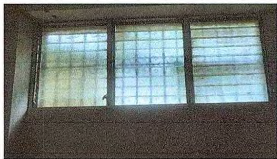
Foto1: Se observan las paletas de vidrio completas
