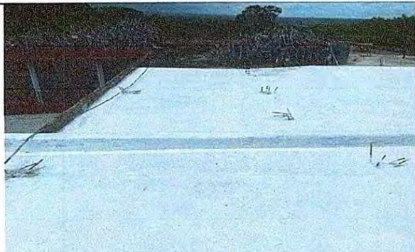
Foto1: Se observan la impermeabilización juntas sismica
