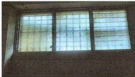
Foto1: Se observan las paletas de vidrio completas
