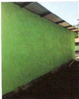
Foto 1: Se observa como quedó el repello y pintura en el aula de parvulos
