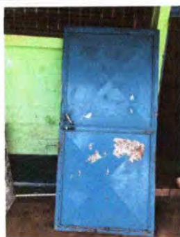
Foto 3: Se observa el cambio de la puerta
