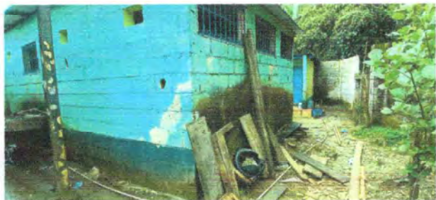
Foto 1: Se observa la necesidad de repellar y aplicar pintura en el aula de parvulos
