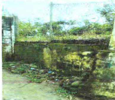
Foto 7: Se observa el mal estado del muro de contención
