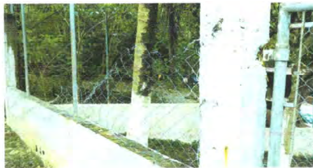
Foto 8: Se observa la necesidad de sustituir la malla galvanizada del muro
