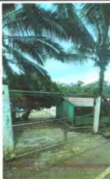
Foto 9: Se observa la necesidad de cambiar el porton debido al mal estado
