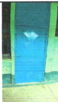
Foto 4: Se observa la necesidad de darle mantenimiento a las puertas
