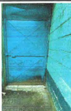
Foto 3: Se observa la necesidad del cambio de las puertas que estan en mal estado
