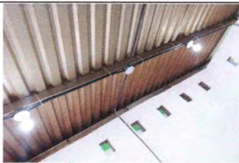
Foto 1: Sistema eléctrico terminado a cabalidad.
