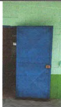
Foto 8: Se observa la necesidad de sustituir puertas
