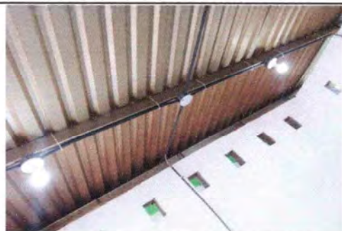
Foto 1: Sistema eléctrico terminado a cabalidad.
