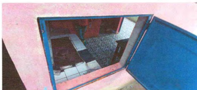
Foto 4: Se observa la necesidad de instalar ventanas
