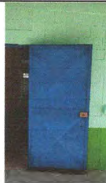
Foto 8: Se observa la necesidad de sustituir puertas
