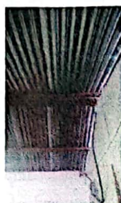
Foto 7: FOTOGRAFIA EN EL MODULO DEL SALON AREA INTERNA ESTADO ACTUAL DE LA LAMINA
