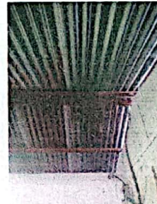
Foto 10: FOTOGRAFIA EN EL MODULO DEL SALON AREA INTERNA ESTADO ACTUAL DE LA LAMINA
