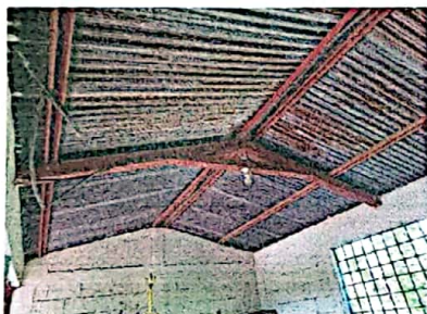
Foto 9: FOTOGRAFIA EN EL MODULO DEL SALON AREA INTERNA ESTADO ACTUAL DE LA LAMINA
