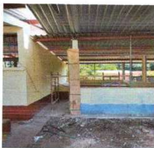
Foto 3: Se observa que la puerta de madera de la cocina ya se quitó
