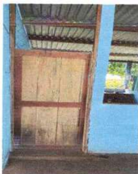
Foto 3: Se observa que la puerta de ingreso a la cocina, ya está en mal estado, por dicha razón es necesario que se sustituya
