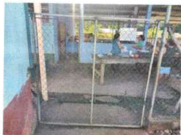
Foto 7: Se observa que el portón que da ingreso a la cocina y comedor, ya está deteriorado, por las inclemencias del tiempo. Por esa razón es necesario sustituirlo.
