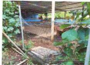
Foto 9: Se observa que la malla perimetral del comedor ya está en malas condiciones. Por dicha razón es necesario sustituirla.
