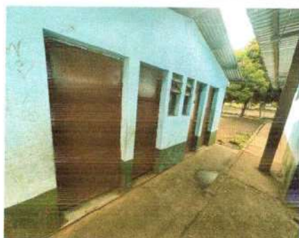
Foto 3: Las puertas principales e internas de los servicios sanitarios necesitan mantenimiento, pero una en específico necesita ser sustituida por problemas de corrosión
