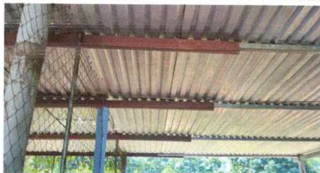
Foto 2: Se puede observar que la estructura metálica que está sobre la cocina necesita mantenimiento, para evitar deterioro.
