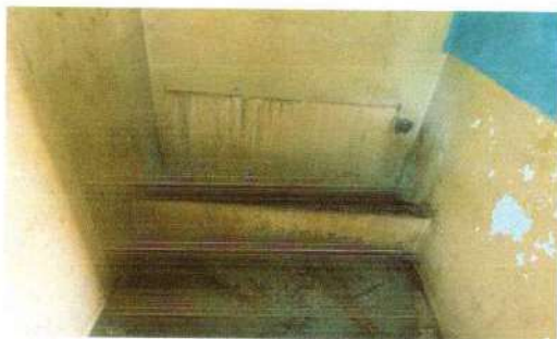
Foto 1: Se observa que el mingitorio del baño de niños ya está en mal estado por esa razón es necesario repararlo.
