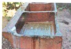
Foto 8: Se observa que la pila que le da servicio al comedor, ya se encuentra en mal estado. Por dicha razón se debe sustituir.
