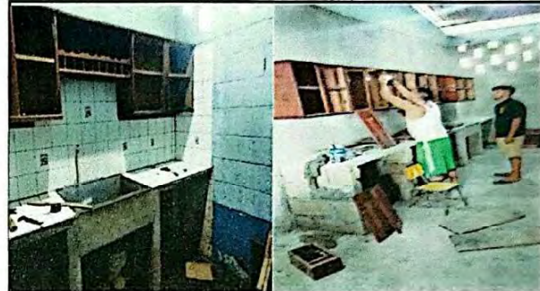
Foto 2: Se observa el deterioro de los muebles de cocina y su proceso de reconstrucción de algunas partes del mismo que ya no servía la madera por comejen y otras que estaban quemadas.
