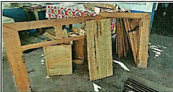
Foto 3: Se observa que la puerta al momento de quitarla se fue terminando de quebrar ya que el comejen había acabado con la mayoría de la misma por lo que fue sustituida en su totalidad.
