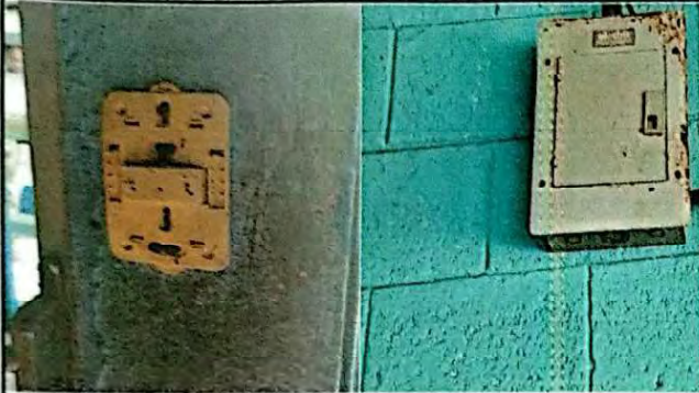
Foto 13: Se observa la mala condición de los apagadores de los salones de clases y dirección y la caja de flípones a donde llega el cable de línea principal.
