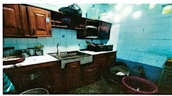
Foto 2: Se observa la mala condición de la cocina. Gabinetes en mal estado, quemados y dañados por comejen.
