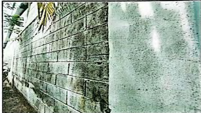
Foto 16: Se observa que varias paredes no cuentan con repello ni pinturas lo que permite el deterioro de la misma con forme para el tiempo y la cercanía al mar.
