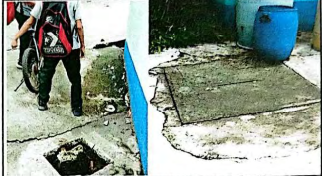
Foto 8: Se observa la red de drenaje las cuales colapsan por lluvias debido a las malas condiciones de cajas, tuberías principales provocando patios con aguas estancadas y lodosas.
