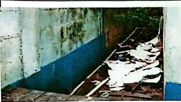
Foto 7: Se observa la mala condición del sistema de tubería debido a su exposición al sol y tiempo se encuentra demasiado dañado por lo que se necesita ser cambiado.
