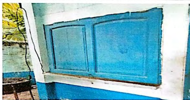
Foto 4: Se observa la ventana de la cocina la cual será reparada, por su condición aun puede ser restaurada.
