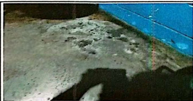
Foto 5: Se observa la mala condición del piso de la cocina con rajaduras y moho debido a la mala red de drenajes y tubería.
