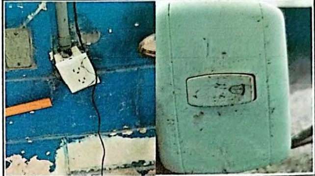
Foto 14: Se observa el timbre el cual no funciona por el mal estado de los cables al igual que el botón o apagador de timbre.
