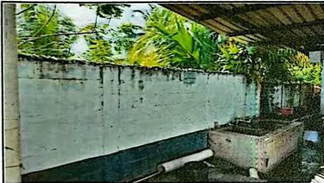
Foto 15: Se observan las malas condiciones de los muros de la escuela los cuales necesitan ser reparados para que no se deterioren cada día mas.
