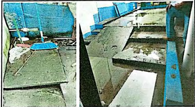
Foto 10: Se observa el mal estado de la red de drenaje provocando que niños rebalen y el estancamiento de agua debido a lluvias.
