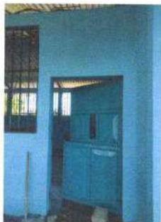
Foto 7: Se observa la puerta de malla que no es segura para guardar los utensilios, de cocina por lo que urge la sustitución de puerta de metal.
