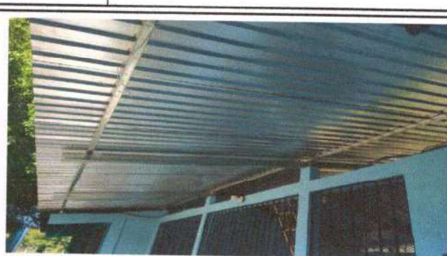
Foto 2: Se observa el mal estado de la estructura de madera por lo que es necesario la Sustitución de estructura de soporte de madera por metal
