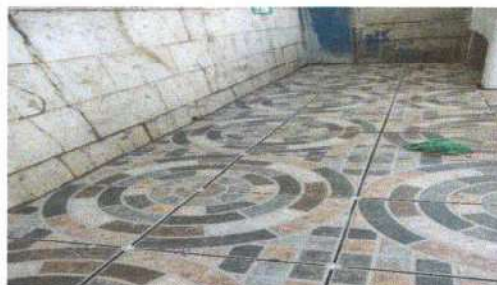
Foto 8: Se observa la pared ya maltratada por lo que se necesita, resane y aplicación de pintura latex acrílicas de muros exteriores e interiores.
