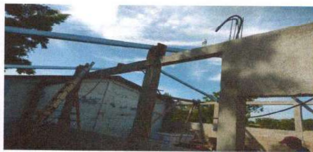
Foto 2: Se observa el mal estado de la estructura de madera por lo que es necesario la Sustitución de estructura de soporte de madera por metal
