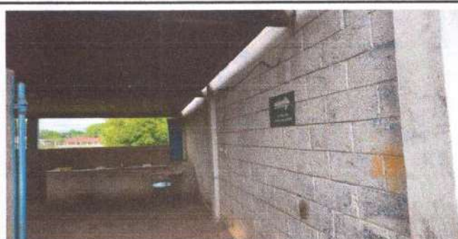
Foto 8: Se observa la pared ya maltratada por lo que se necesita, resane y aplicación de pintura latex acrílicas de muros exteriores e interiores.
