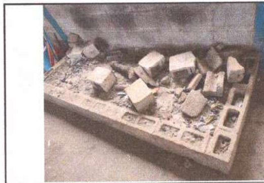
Foto 6: El polleton es una imprvización por lo que es necesario la Sustitución de estufa rural ( completa) incluye chimenea y plancha de metal
