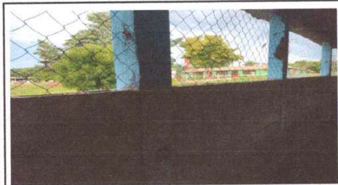
Foto 3: Se observa el muro rajadas con las columnas en mal estado por lo que es necesario, la reparación de muro de block (incluye columnas y soleras)
