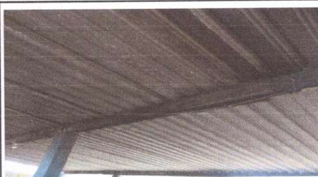
Foto 2: S observa el mal estado de la estructura de madera por lo que es necesario la Sustitución de estructura de soporte de madera por metal
