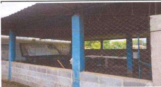
Foto 4: Se observa la malla en mal estado por lo que no es seguro dejar los utensilios de cocina, por lo que es necesario la Sustitución de malla por balcon.
