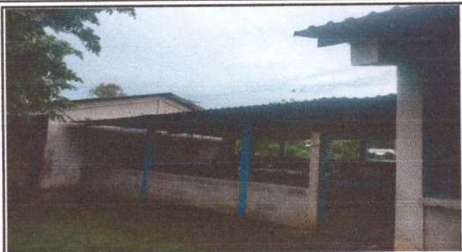
Foto 1: Se observa que la lámina y se encuentra en mal estado por lo que es necesario la sustitución de lamina por lamina troquelada aluzinc calibre 26 (incluye capote, tornillos, desmontaje y montaje)
