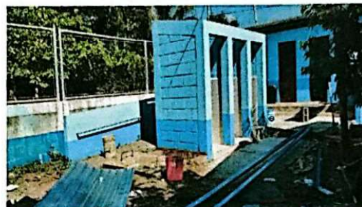
Foto 2. Se observa el cambio de la estructura en modulos de baños.
