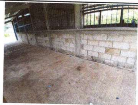
Foto 5: Se observa la necesidad de mejorar el piso del corredor
