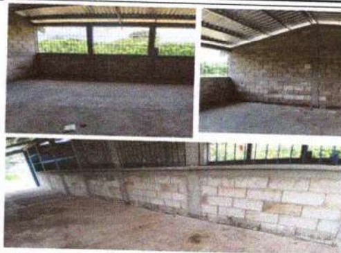
Foto 2: Se observa que muros necesitan mantenimiento (repello y pintura)
