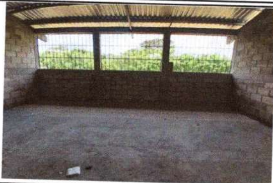
Foto 1: Se observa que el piso en las aulas necesita mejoramiento
