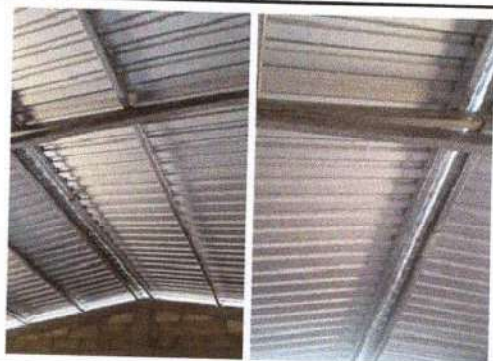
Foto 3: Se observa que aulas carecen de instalación eléctrica
