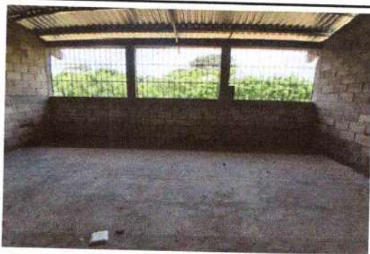
Foto 4: Se observa que muros carecen de repello
