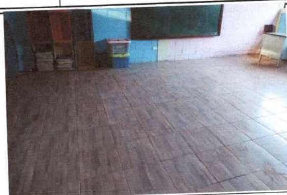
Foto 8: piso ceramico aulas
