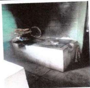
Foto 1: Estufa de leña, se observa mal estado
