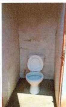
Foto 3: se observa la necesidad e instalar azulejo
