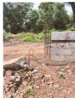
Foto 8: Se observa la necesidad de reparar el muro perimetral
