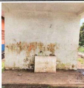
Foto 5: Se observa la necesidad resane y pintura latex en paredes
