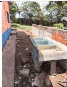
Foto 2: Se observa la pila deteriorada
