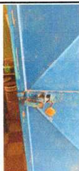
Foto 11: Se observa la necesidad de cambio de chapa para aulas modulo 2
