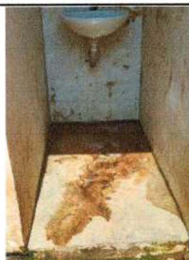
Foto 4: Se observa la necesidad de piso ceramico
