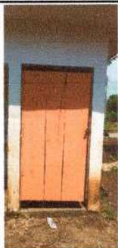
Foto 1: Se observa una de las puertas a sustituir
