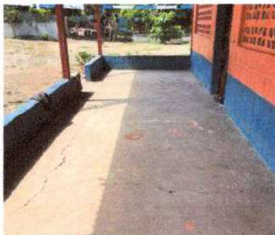
Foto 13: Se observa deterioro en piso modulo aula 2
