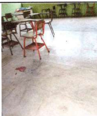
Foto 9: se observa la necesidad de la instalación de piso cerámico
