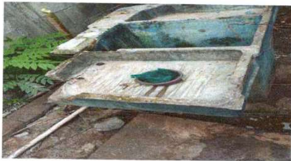
Foto 7: MÓDULO 5. Se observa pila en muy malas condiciones.
