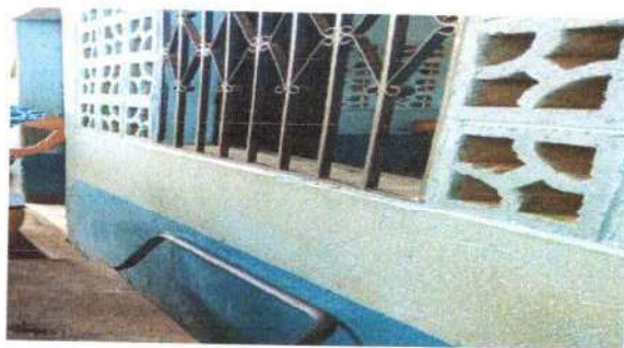
Foto 5. MÓDULO 4. Se observa que los balcones necesitan mantenimiento.
