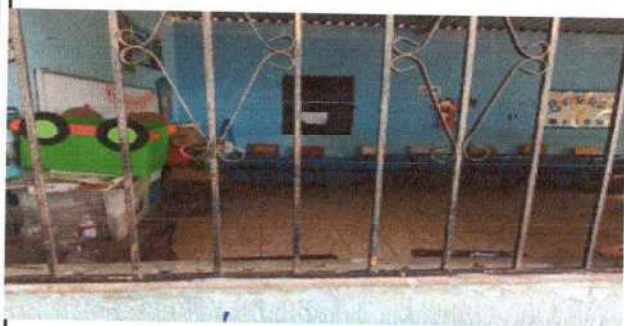
Foto 15: MÓDULO 9. Se observa los balcones en mal estado.
