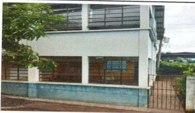
Foto 3: . MÓDULO 2. Se observa mal estado en paredes por lo que necesita pintura.
