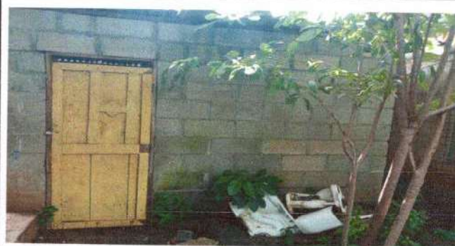
Foto 10: MÓDULO 7. Se observa mal estado de puerta de madera y paredes.
