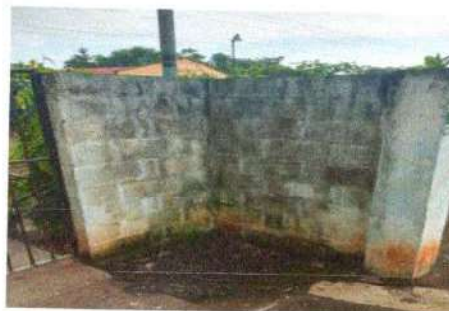
Foto 2. MÓDULO 1. Se observa que pared necesita mantenimiento.
