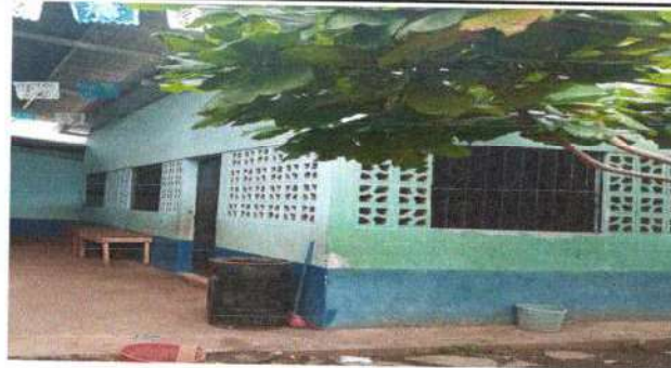
Foto 16: MÓDULO 9. Se observa el mal estado en las paredes.
