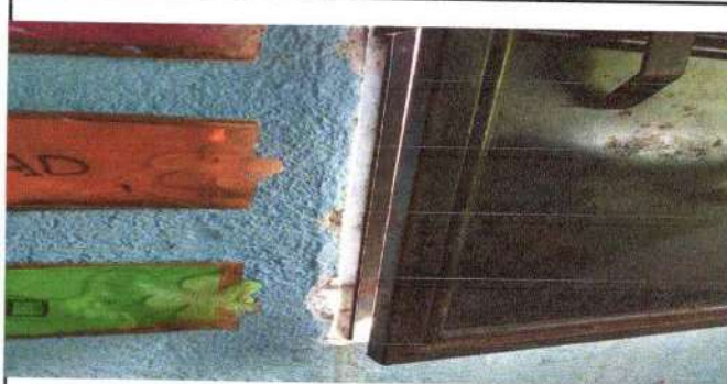
Foto 14: MÓDULO 9. Se observa el marco de la ventana despegado de la pared, necesita mantenimiento.
