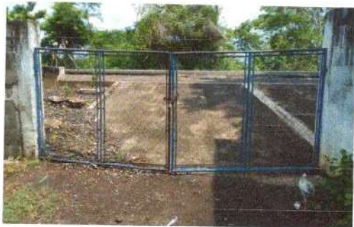
Foto 1. MÓDULO 1. Se observa portón de ingreso en muy malas condiciones.
