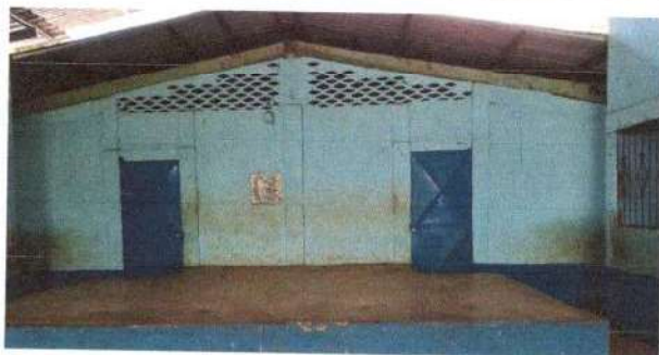
Foto 13: MÓDULO 8. Se observan las paredes en malas condiciones.
