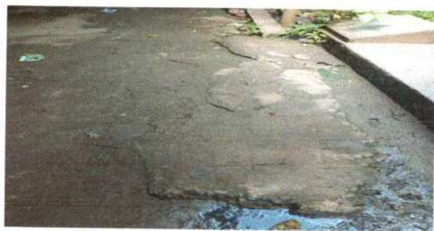
Foto 9: MÓDULO 6. Se observa la plancha de concreto en mal estado.
