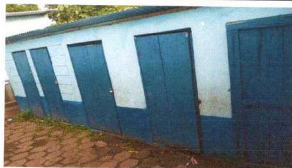
Foto 8: MÓDULO 6. Se observa el mal estado de las puertas.
