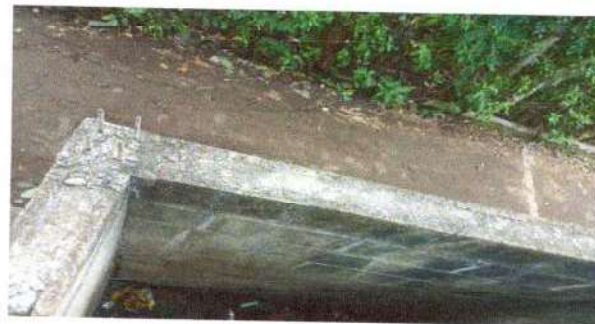
Foto 4: MÓDULO 3 Se observa la necesidad de conformación del muro perimetral.
