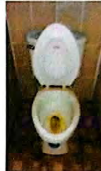
Foto 8: Se observa que el inodoro se encuentra en mal estado.
