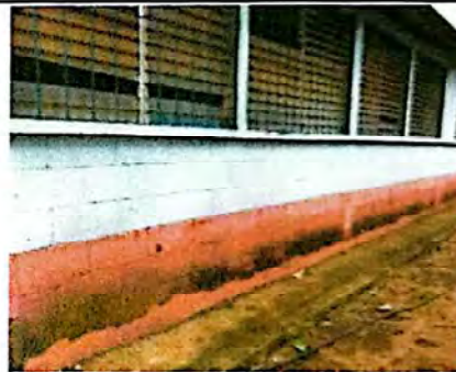
Foto 10: Se observa en mal estado la pintura.
