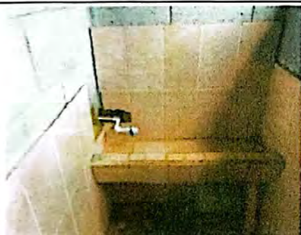
Foto 9: Se observa que el mingitorio se encuentra en mal estado.
