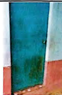
Foto 2: Se observa que las puertas necesitan mantenimiento.
