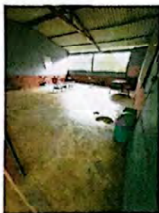
Foto 1: Se observa que se necesitan mejoras en el piso.
