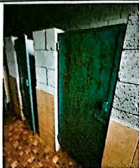
Foto 7: Se observa que las puertas de servicios sanitarios necesitan mantenimiento.
