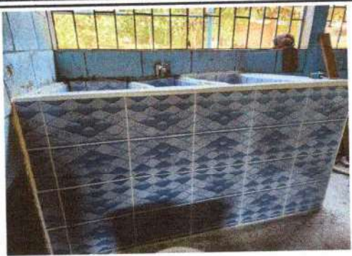
Foto1: Tanque de dos lavaderos con azulejo.
