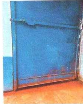
Foto 20: Se observa la puerta de los baños de los niños en mal estado.
