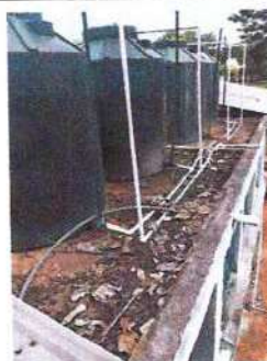
Foto 4: Se observa la terraza de los baños y accesorios de rotomats en mal estado
