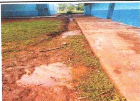
Foto 11: Se observa la falta de cuneta de aguas pluviales.
