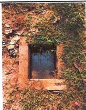
Foto 15: Se observa la falta de tapaderas de cajas
