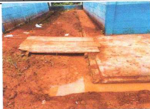
Foto 14: Se observa la falta de tubería línea principal aguas pluviales.
