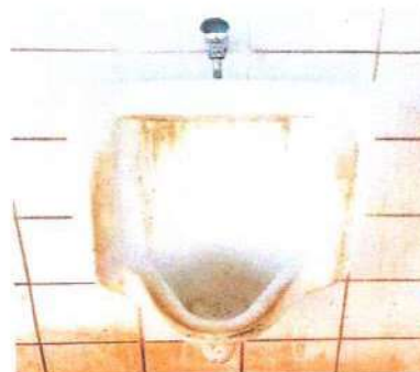
Foto 10: Se observa el mingitorio en mal estado.
