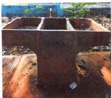
Foto 17: Se observa lavaderos en mal estado.
