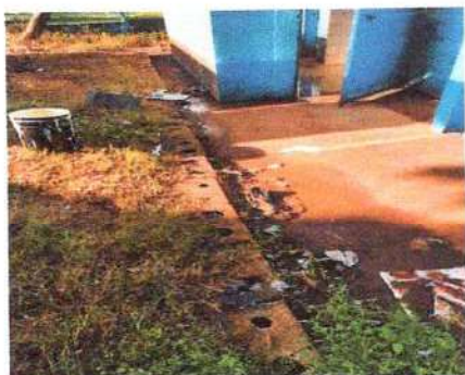
Foto 9: Se observa que el agua de lluvia y lodo ingresa al modulo de baños y cuneta.
