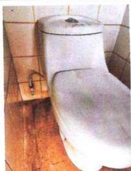
Foto 5: Se observa los accesorios de los baños en mal estado hay fuga de agua.
