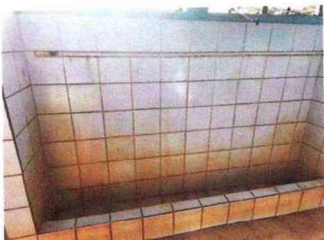
Foto 7: Se observa el mingitorio en mal estado.
