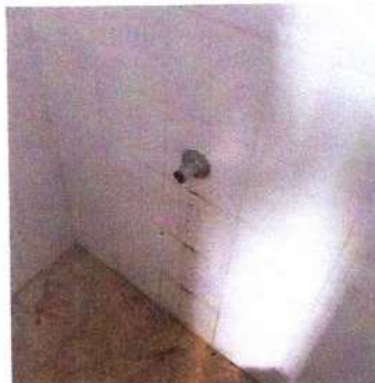
Foto 8: Se observa las llaves de las duchas en mal estado.
