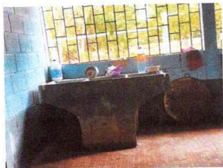
Foto 1: Se observa que pila de concreto, se encuentra en mal estado.
