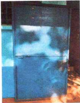
Foto 21: Se observa las puertas de todas las aulas y baños en mal estado.
