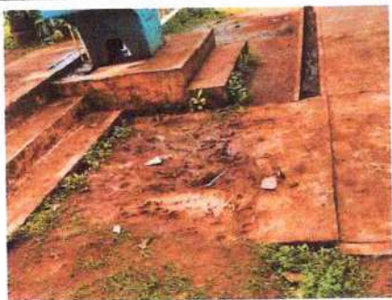
Foto 13: Se observa las planchas de concreto en el patio en mal estado.
