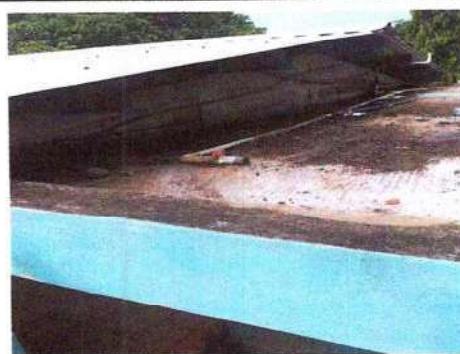
Foto 16: Se observa tubería de pvc con suciedad interna y en mal estado.
