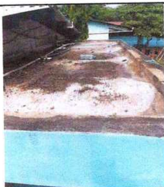
Foto 3: Se observa la terraza de los baños en mal estado, se necesita impermeabilización y reparación de pañuelos en ambas.
