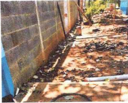
Foto 19: Se observa la falta de banqueta de concreto.
