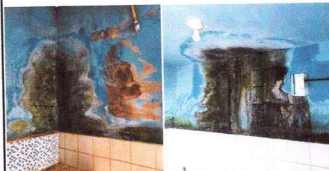
Foto 2: Se observa que las paredes de los baños están deterioradas, se necesita repello.
