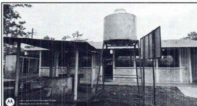
Foto 4: Se observa que las paredes están muy sucias. Es necesario resane y aplicación pintura latex acrílica en muros exteriores e interiores (incluye mejora en deformaciones y agujeros. Aula de Parvulos.
