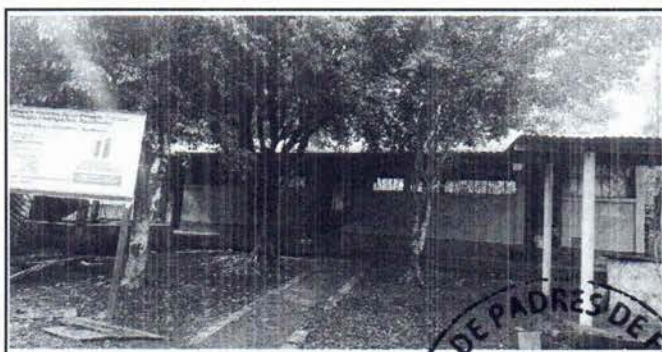
Foto 5: Se observa que las paredes están muy sucias. Es necesario resane y aplicación pintura latex acrílica en muros exteriores e interiores (incluye mejora en deformaciones y agujeros. Aula de primaria.
