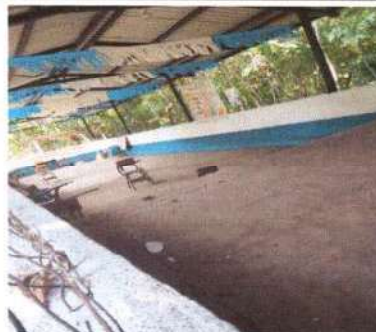
Foto 2: En módulo 1, debido al deterioro del piso rústico se tiene la necesidad de cambiarlo por piso cerámico.
