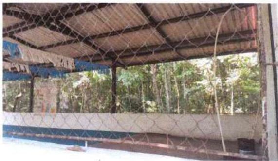
Foto 1: En módulo 1, se ve la necesidad de sustituir la malla por balcones de metal.
