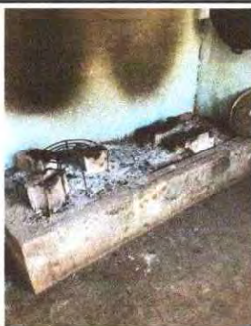
Foto 3: Se observa que la estufa rural, de la cocina se encuentra en mal estado
