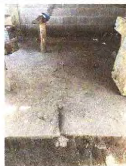
Foto 4: Se observa la torta de cemento de la cocina que se encuentra en mal estado
