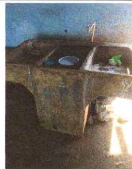
Foto 2: Se observa que la pila de la cocina, se encuentra en mal estado
