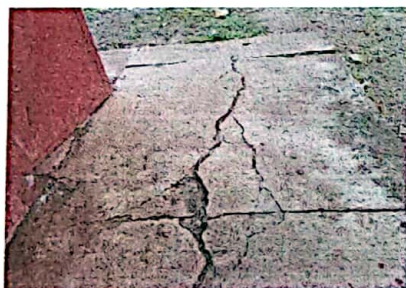
Foto 3: FOTOGRAFIA DEL ESTADO ACTUAL DEL PISO DEL PATIO
