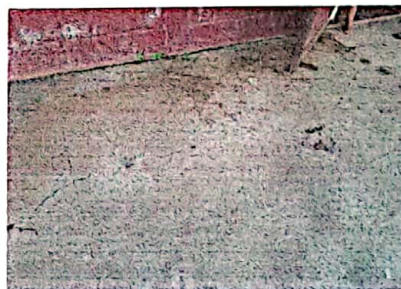
Foto 4: FOTOGRAFIA DEL ESTADO ACTUAL DEL PISO DEL PATIO
