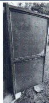
Foto 2: Se observa la necesidad de la instalación de una puerta de metal.
