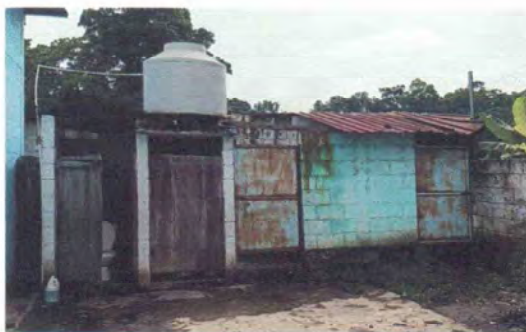
Foto 1: Se observa un deterioro elevado en la lámina, estando esta oxidada y con perforaciones; por lo cual es necesario su sustitución.
