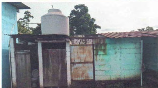
Foto 9: Las paredes de los servicios sanitario demuestran un acabado muy rústico y esto provoca el deterioro de la infraestructura, por lo que es necesario repellar los muros.
