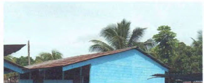
Foto 10: El techo de uno de los módulos de aulas evidencia mal estado, estando oxidadas y esto provoca filtraciones.
