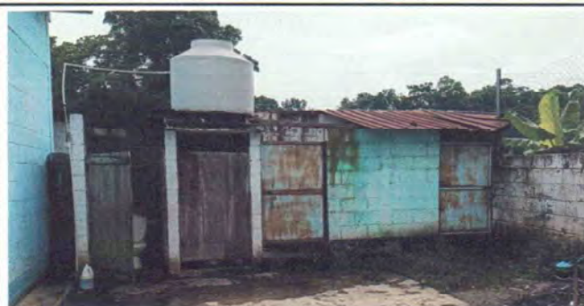
Foto 4: Las paredes presentan suciedad y un estado general deficiente, por lo que se necesita aplicarles pintura.
