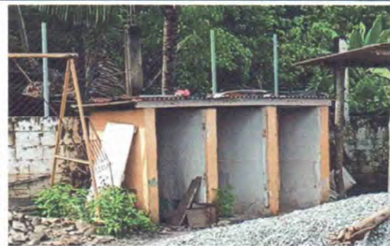
Foto 8: Es evidente la necesidad de la instalación de un mingitorio, ya que los servicios sanitarios son pocos para la cantidad de estudiantes.
