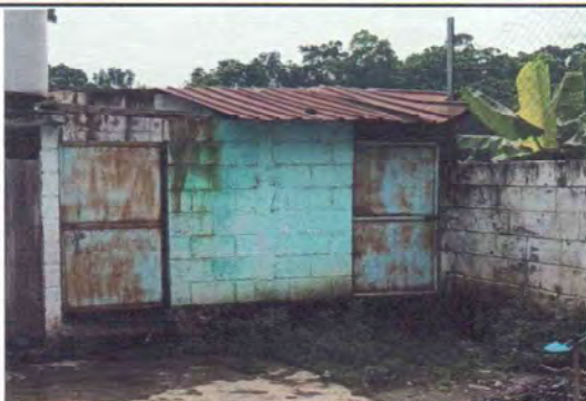
Foto 3: Las puertas evidencian un mal estado, presentando óxido y daño, por lo que es necesario darle mantenimiento.
