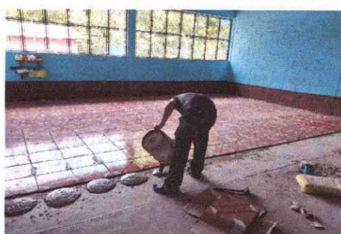
Foto 1: Se observa que continuan trabajando dentro de las aulas con el piso cerámico
