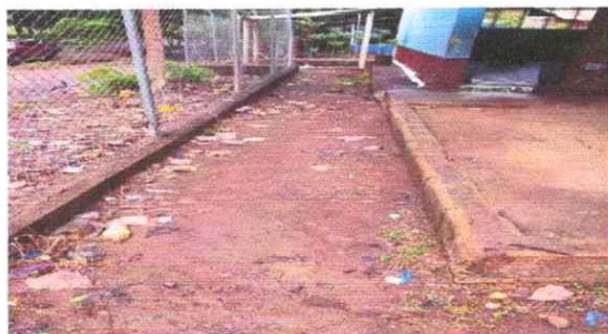
Foto 5: Se observa la necesidad de suministrar torta de concreto
