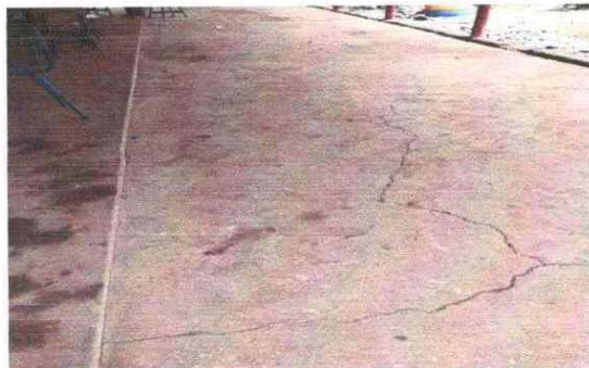
Foto 1: Se observa que el modulo 1 el pasillo se encuentra en mal estado
