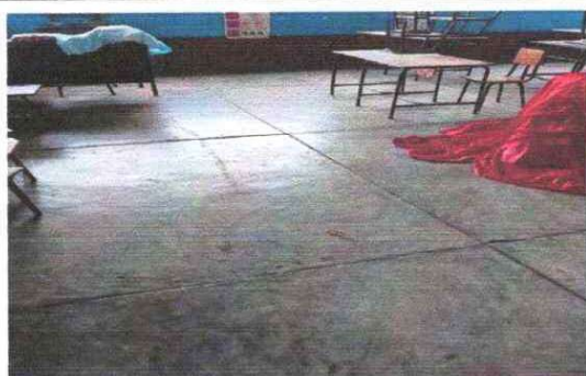
Foto 3: Se observa que en el modulo 1 el piso se encuentra en mal estado.
