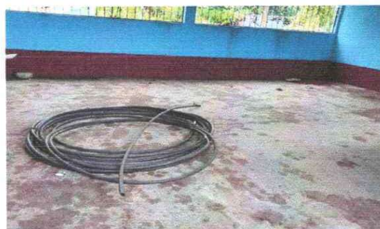
Foto 4: Se observa que en el modulo 2 el piso se encuentra en mal estado y humedad
