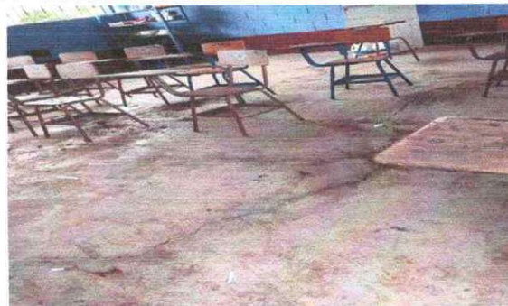
Foto 2: Se observa que sen el modulo 2 el piso se encuentra en mal estado
