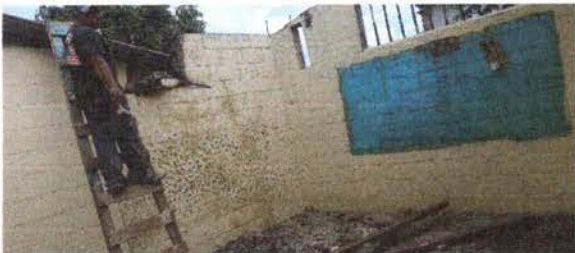
Foto 5: Se observa la extracción del ventanal en mal estado.
