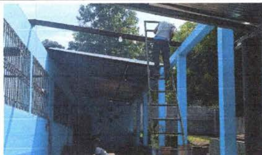
Foto 11: Se observa la extracción de la estructura de soporte metálica en mal estado.
