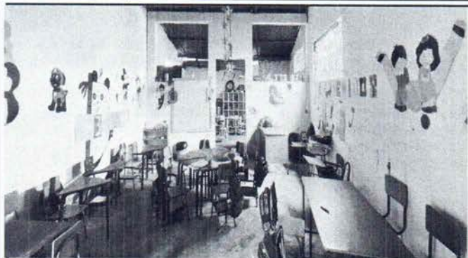
Foto 7: Se observa que las paredes necesitan repello.
