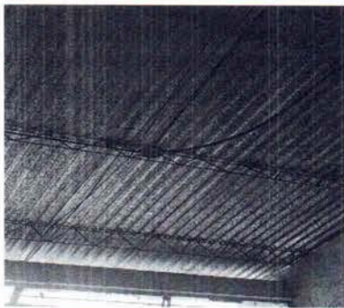
Foto 1: Se observa que el techo de aulas esta en mal estado es necesario su sustitucion
