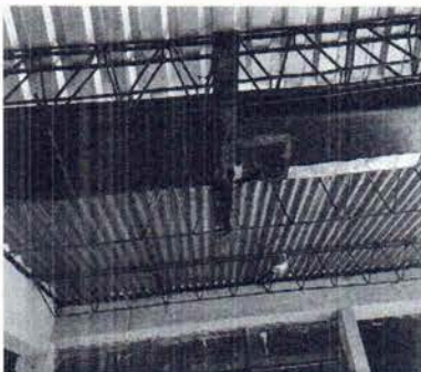
Foto 3: Se observa que el canal de metal de aulas esta en mal estado es necesario su sustitución
