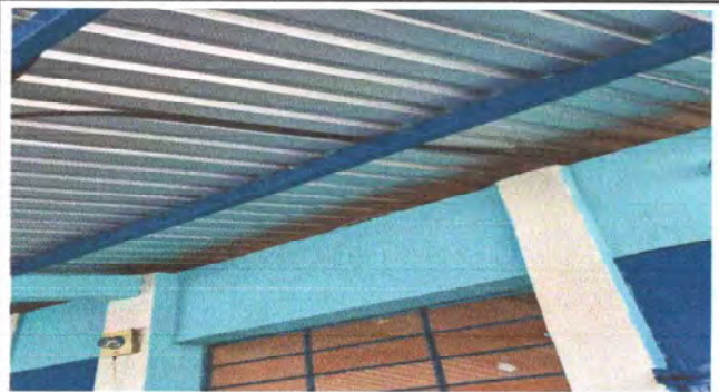
Foto 8: Se observa la mejora con el cambio de la lamina
