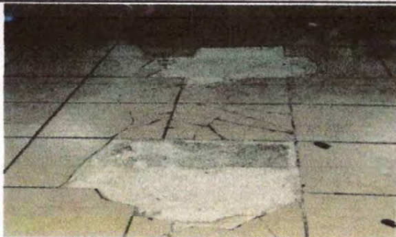
Foto 1: Se observa el mal estado del piso cerámico
