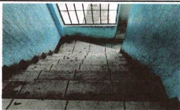
Foto 5: Se observa la falta de pasamanos en las gradas
