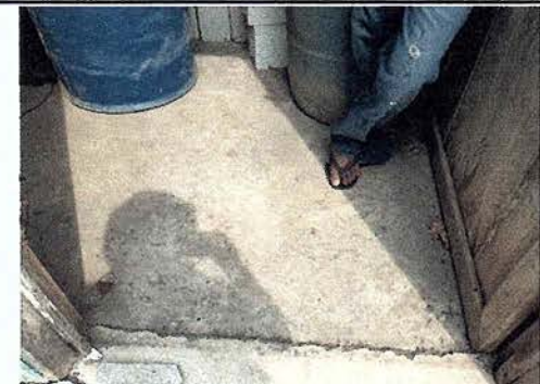
Foto 6: Se observa que el piso de la cocina necesita mejoramiento.
