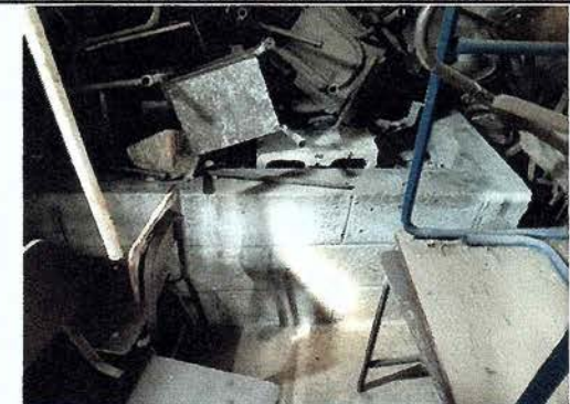
Foto 4: Se observa la estufa rural abandonada, la cual necesita reparación
