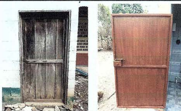
Foto 8: Se observa que la puerta de la cocina necesita sustitución y las puertas de los servicios sanitarios mantenimiento preventivo
