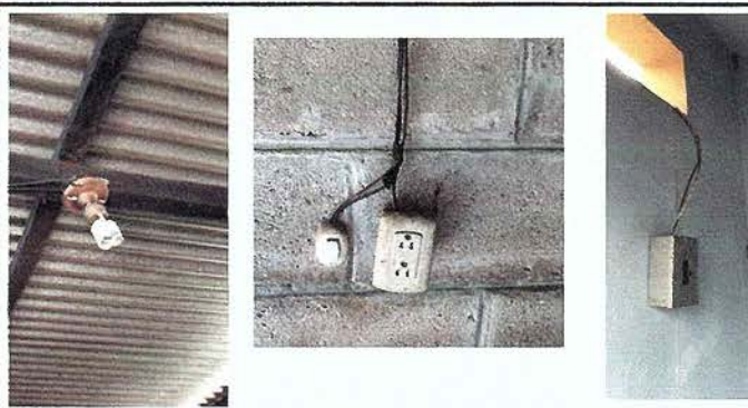
Foto 10: Se observa que el sistema eléctrico de la cocina y la bomba de agua necesitan reparación
