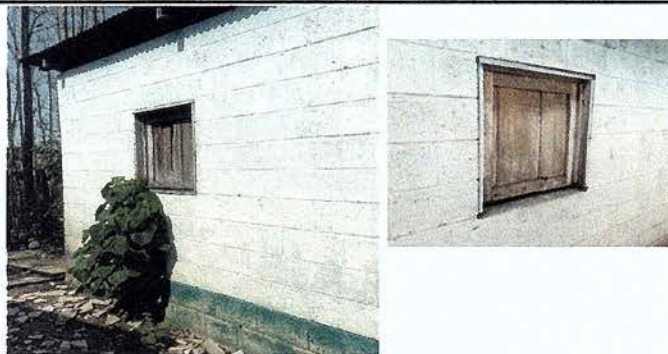
Foto 5: Se observan las ventanas de madera en mal estado.
