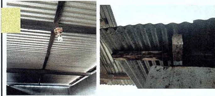
Foto 3: Se observa la lámina de zinc y estructura de madera en mal estado, es necesario su sustitución
