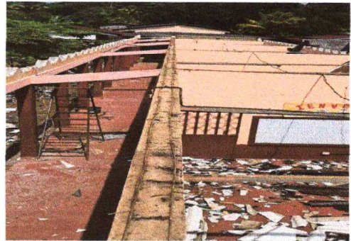
Foto 2: Se observa a la hora del desmontaje que no tenía estructura en el techo.
